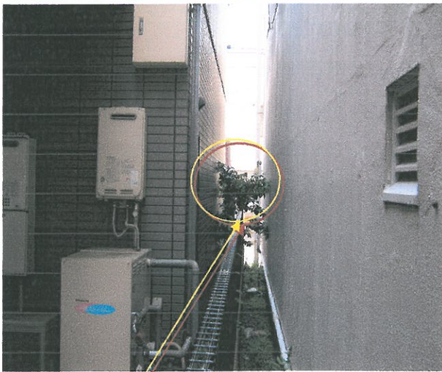
隙間から店舗裏側へ侵入
