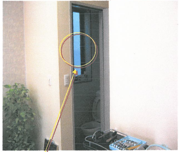
店舗裏側のトイレの小窓から侵入
