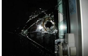
窓ガラス焼き破り
