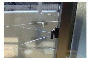
窓ガラスこじ破り
